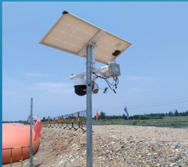
现场视频监控系统
